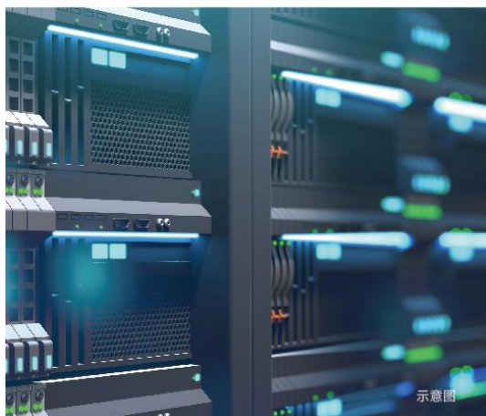
设备在线巡检
